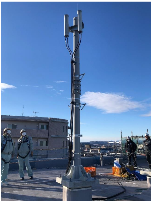
<本支持柱を使用した 携帯電話基地局のアンテナ>
